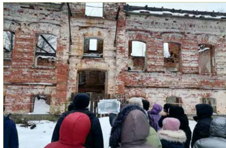
К сожалению, бывшая усадьба Любищева в Оскуе находится в разрушенном состоянии.
