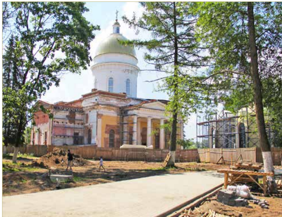
В сквере имени Кирова и возле Троицкого собора в Боровичах идут масштабные работы по строительству и реконструкции.
